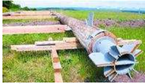
Die Seitenteile des Aussichtsturms wurden auf der Kuppe des Heimbergs vormontiert. Am kommenden Montag werden die beiden Teile mit einem Kran aufgerichtet und miteinander verbunden. Foto: privat
